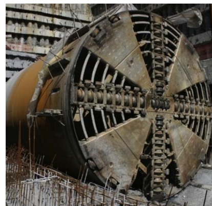
Общий вид щитового тоннелепроходческого комплекса на проекте по строительству тоннеля Отогар-Багсилар, Стамбул, Турция (заимствование из [16])
