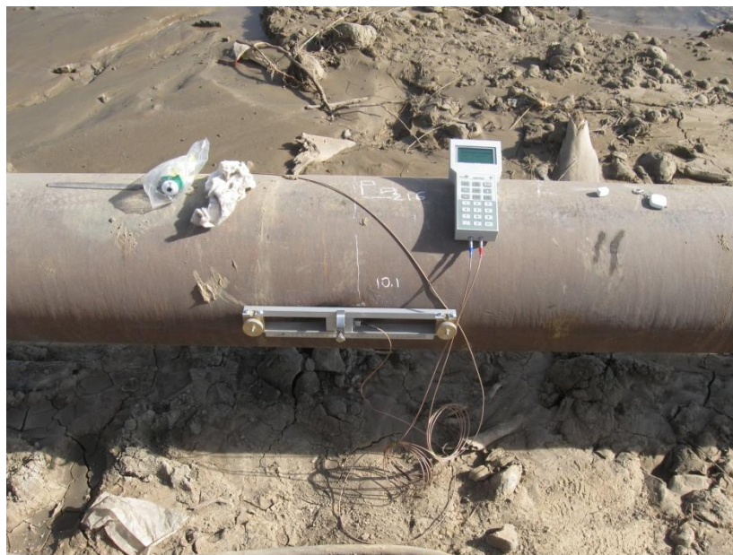
Рис. 2. Монтажная схема первичного прибора, а, и общий вид расходомера, установленного на подводящем трубопроводе, б
