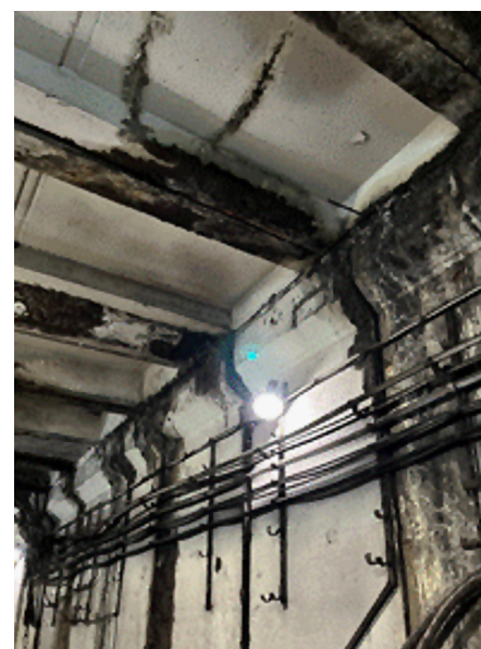
Рис. 3. Выщелачивание и разрушение бетонной конструкции плиты перекрытия в результате эрозии гидроизоляции
