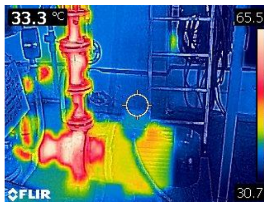
Рис. 6. Насос горячей воды – запорная арматура без теплоизоляции
