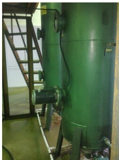
Рис. 3. Установка УЗ-агрегата на сорбционную колонну СНК-640
